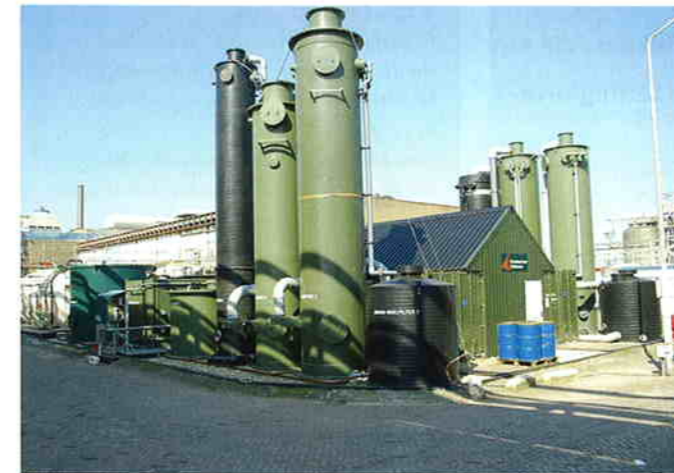
De waterzuivering, het hart van de installatie.
